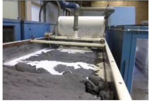
Blick in die Filtrieranlage.
