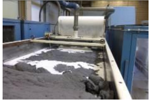
Blick in die Filtrieranlage.
